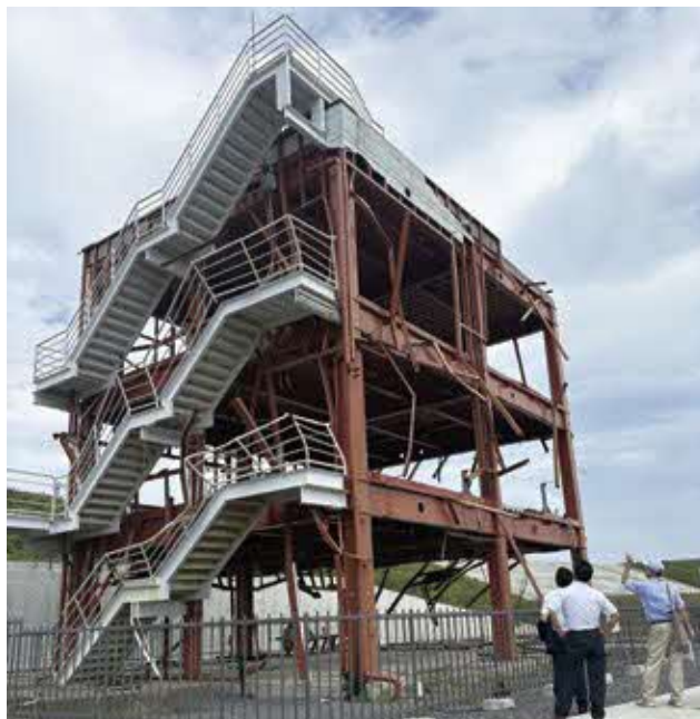
(被害を受けた防災庁舎)
