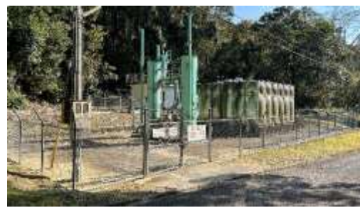
【石河内地区浄・配水池 全景】
