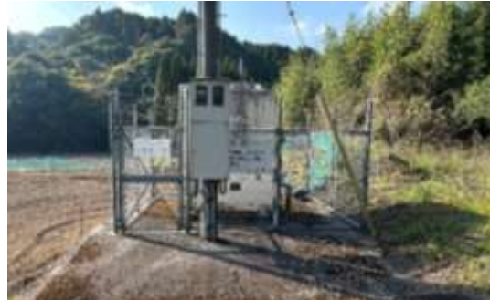
【中央地区田神上地区加圧ポンプ場 全景】
