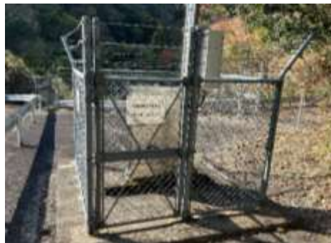
【中八重加圧ポンプ場 全景】
